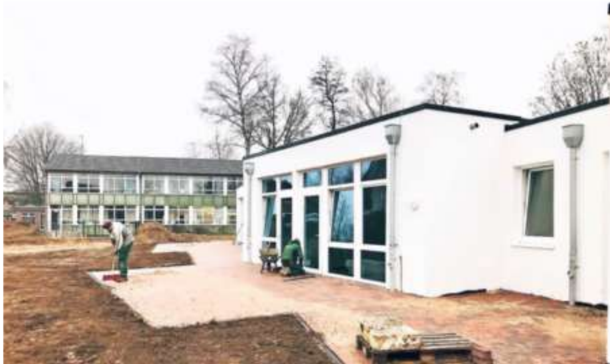
Nur einen Steinwurf entfernt vom Ringenberger Schlosskindergarten (l.), der sich in der ehemaligen Schule befindet, wurde die neue Tagesstätte Am Wolfsdeich errichtet. Aktuell finden dort noch Pflasterarbeiten statt. RP-FOTO: KLAUS NIKOLEI
